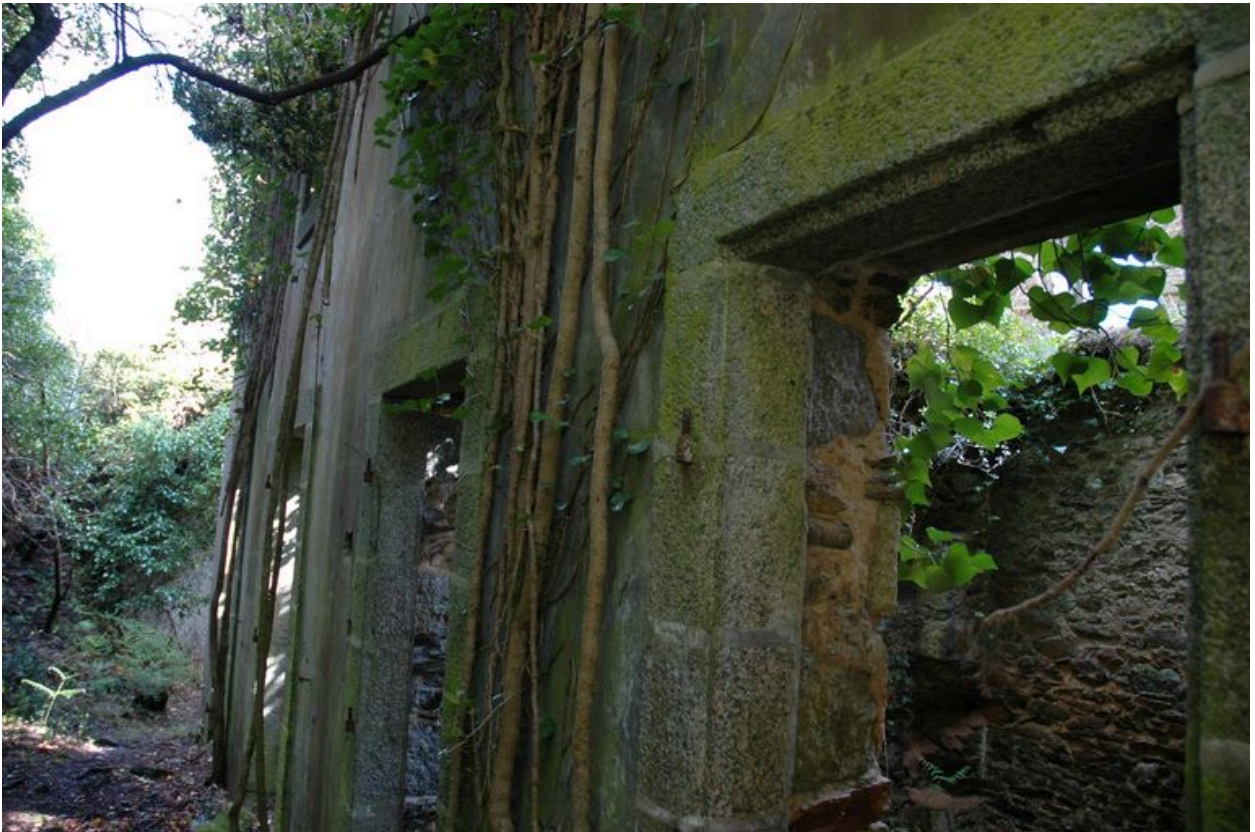
Vue de la pointe des Espagnols : la batterie basse et ses casernements ruinés (19e siècle)
