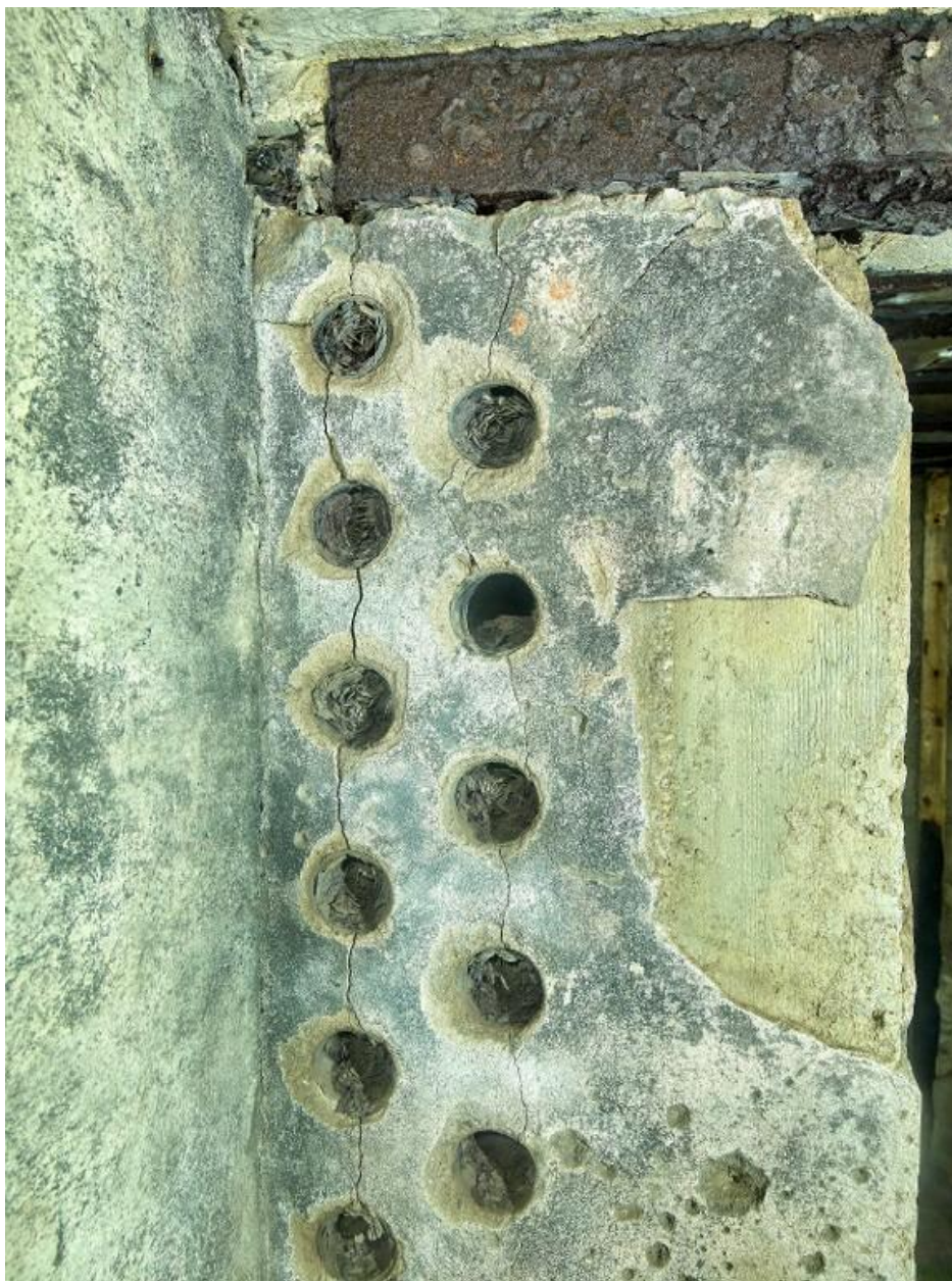
Vue du passage des câbles de la salle des compensateurs au puits d'antenne sud-ouest via un sas étanche
