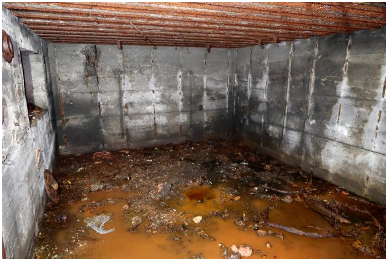
Vue intérieure : salle de garde sud. Au sol et baignant dans l'eau, divers artéfacts rouillés et débris de munitions
