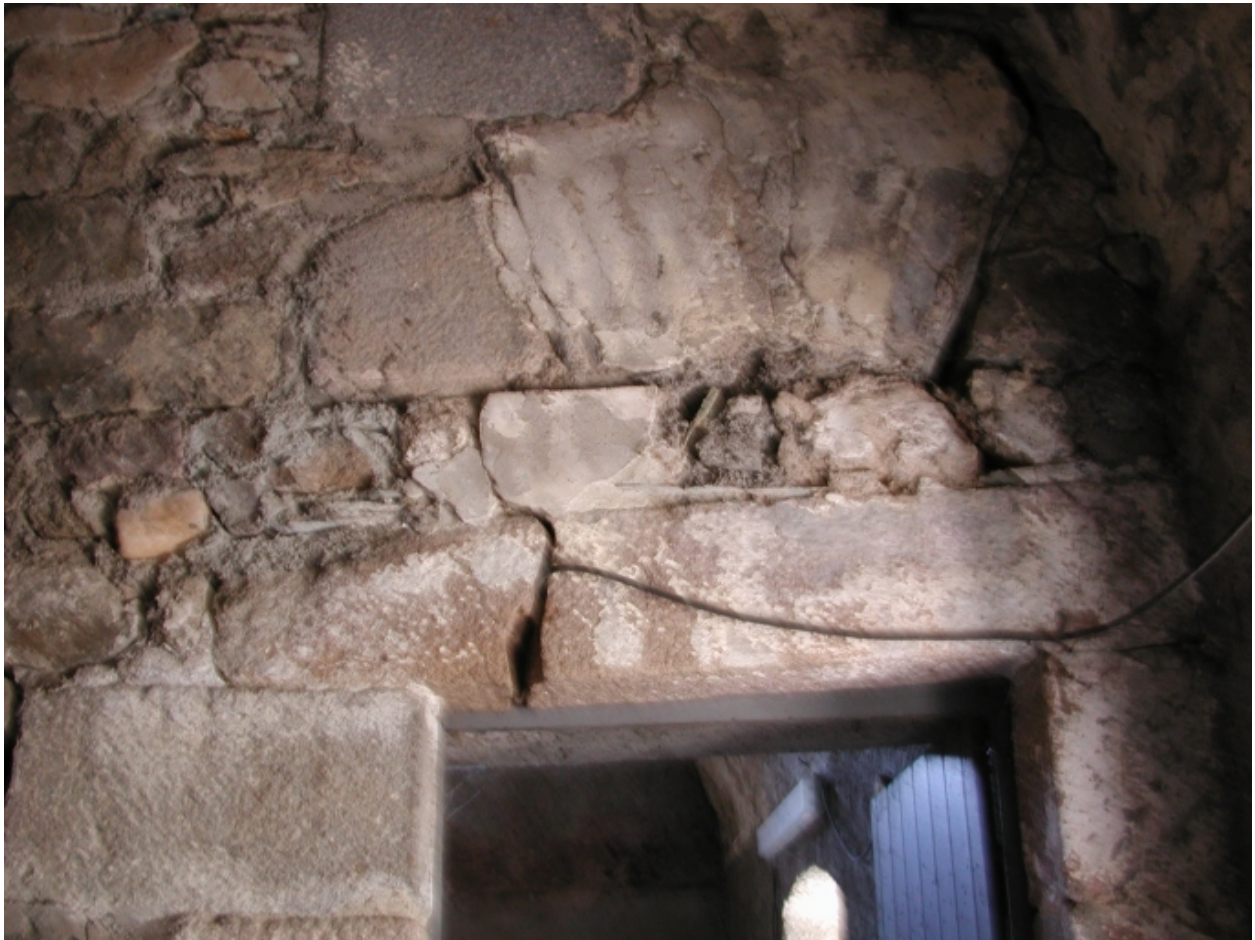
Vue de l'ouverture de la salle est du 1er étage avec le linteau fendu
