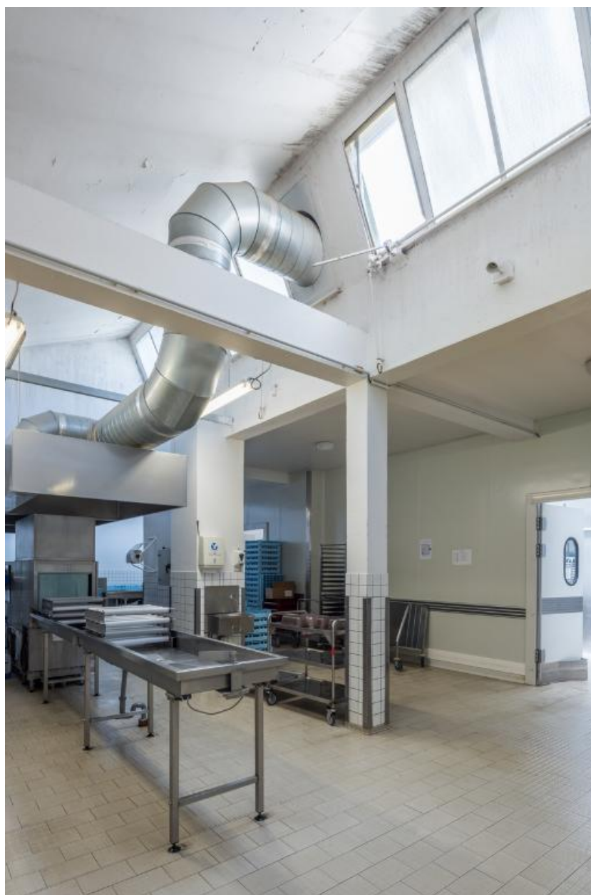
Vue intérieure des cuisines : lave-vaisselle, évacuation des vapeurs et des baies du lanternon.
