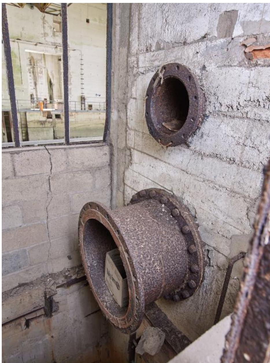
Vue de la salle des pompes de l'alcôve D (quai n° 19) aménagée dans l'épaisseur du mur de refend : fosse technique en sous-sol
