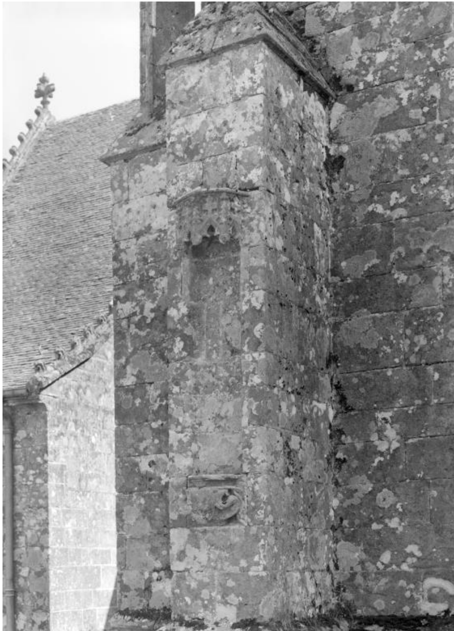
Niche du contrefort nord-est du bras du transept nord (perpendiculaire au mur nord).
