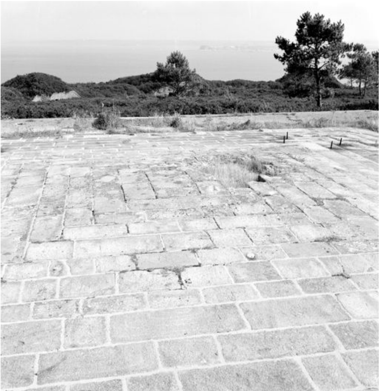
Vue de la tour-modèle n° 1 type 1811 de la pointe des Espagnols en 1969 : terrasse. Le parapet crénelé a été arasé pendant la Seconde Guerre Mondiale
