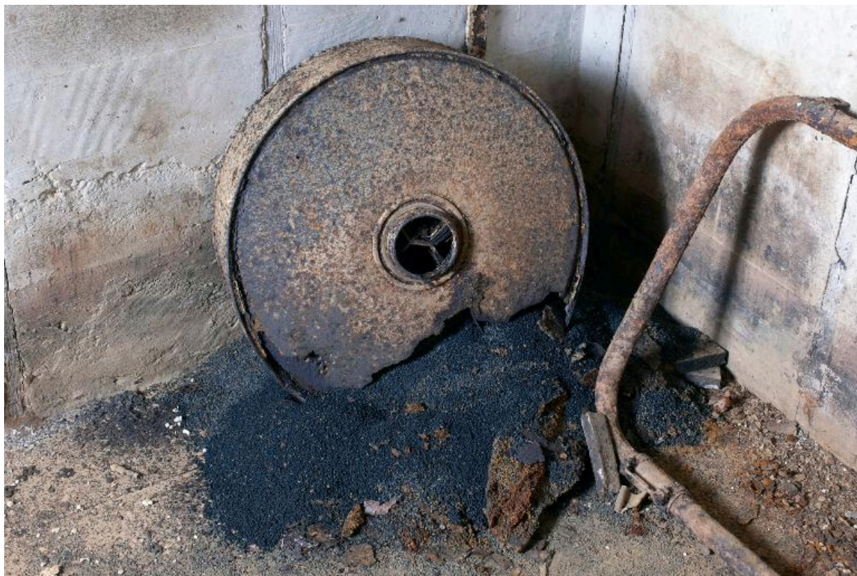
Filtre à charbon du ventilateur (à terre), photographie réalisée le 11 mai 2009
