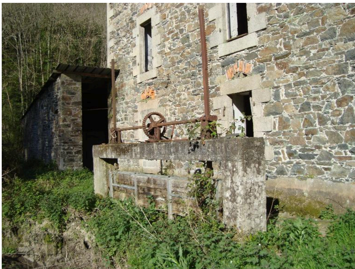
Vanne de régulation en amont de la turbine et bâtiment 1
