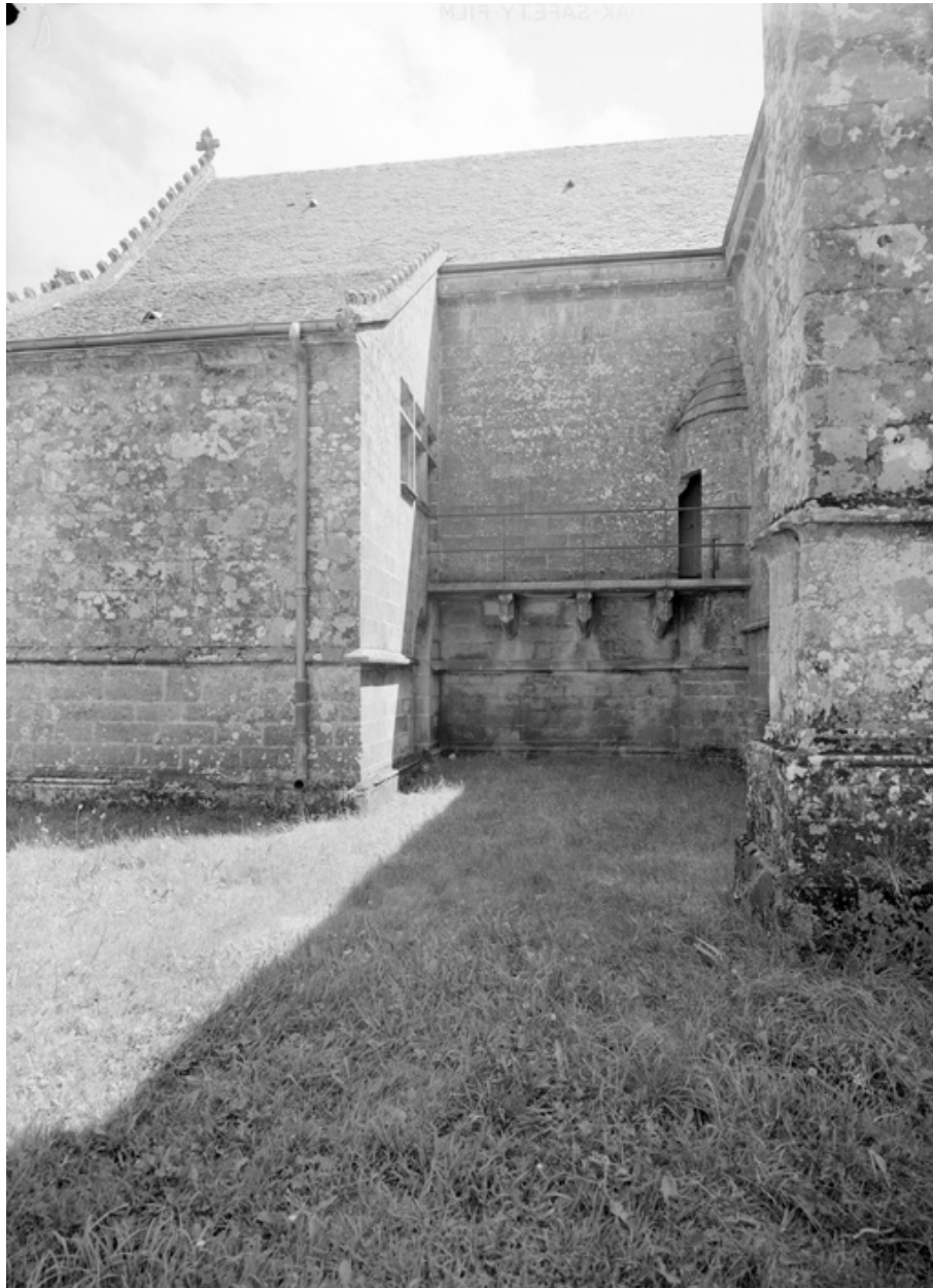
Façade nord, ancienne coursière entre l'oratoire supérieur et la tour d'escalier du bras nord.
