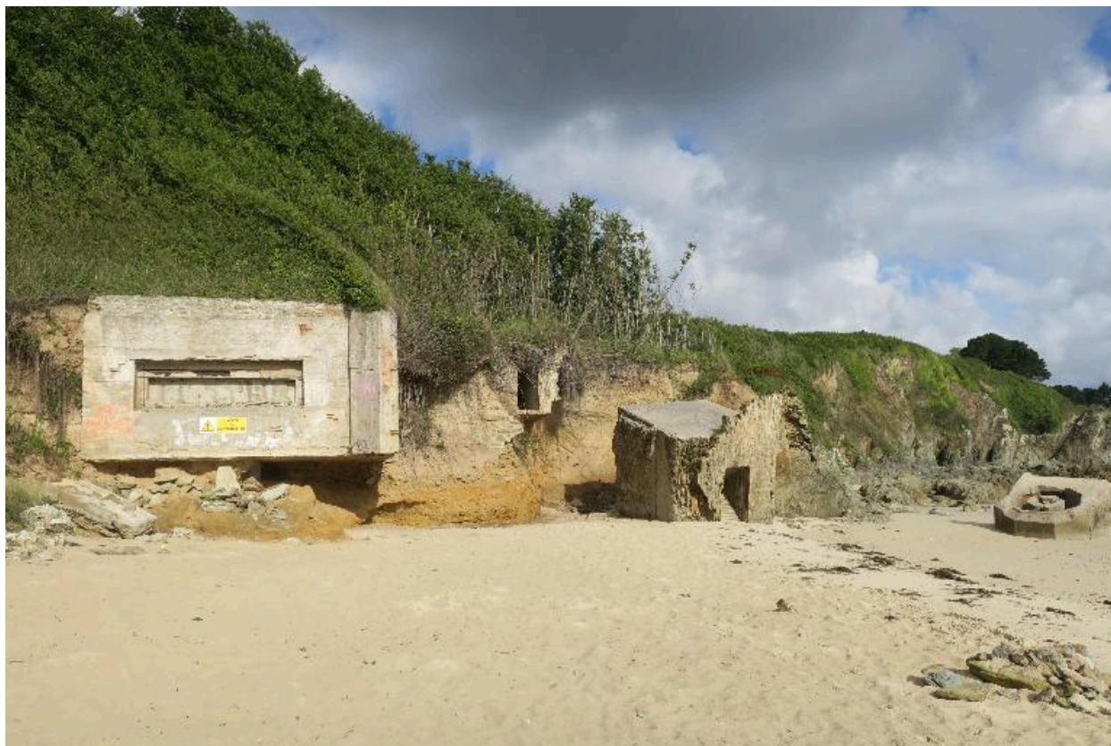
Locmaria, Grands Sables, extrémité ouest effondrée.
