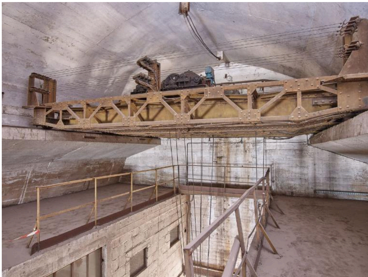
Vue du pont roulant arrière doté de ses deux treuils (pont roulant de la période allemande)
