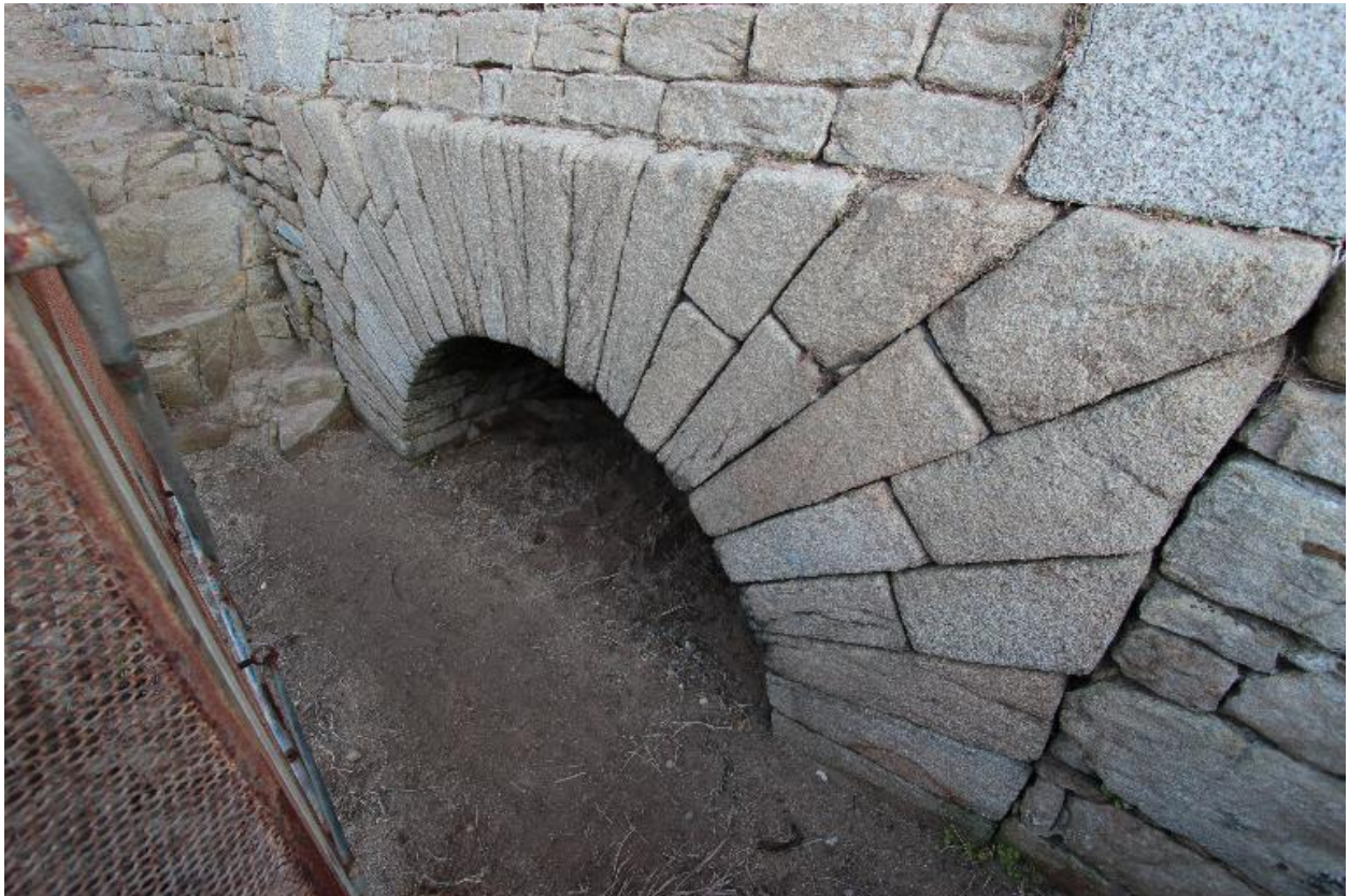
Saint-Pierre-Quiberon, fort de Penthievre, enceinte, arc sous le créneau de pied du front sud-ouest.
