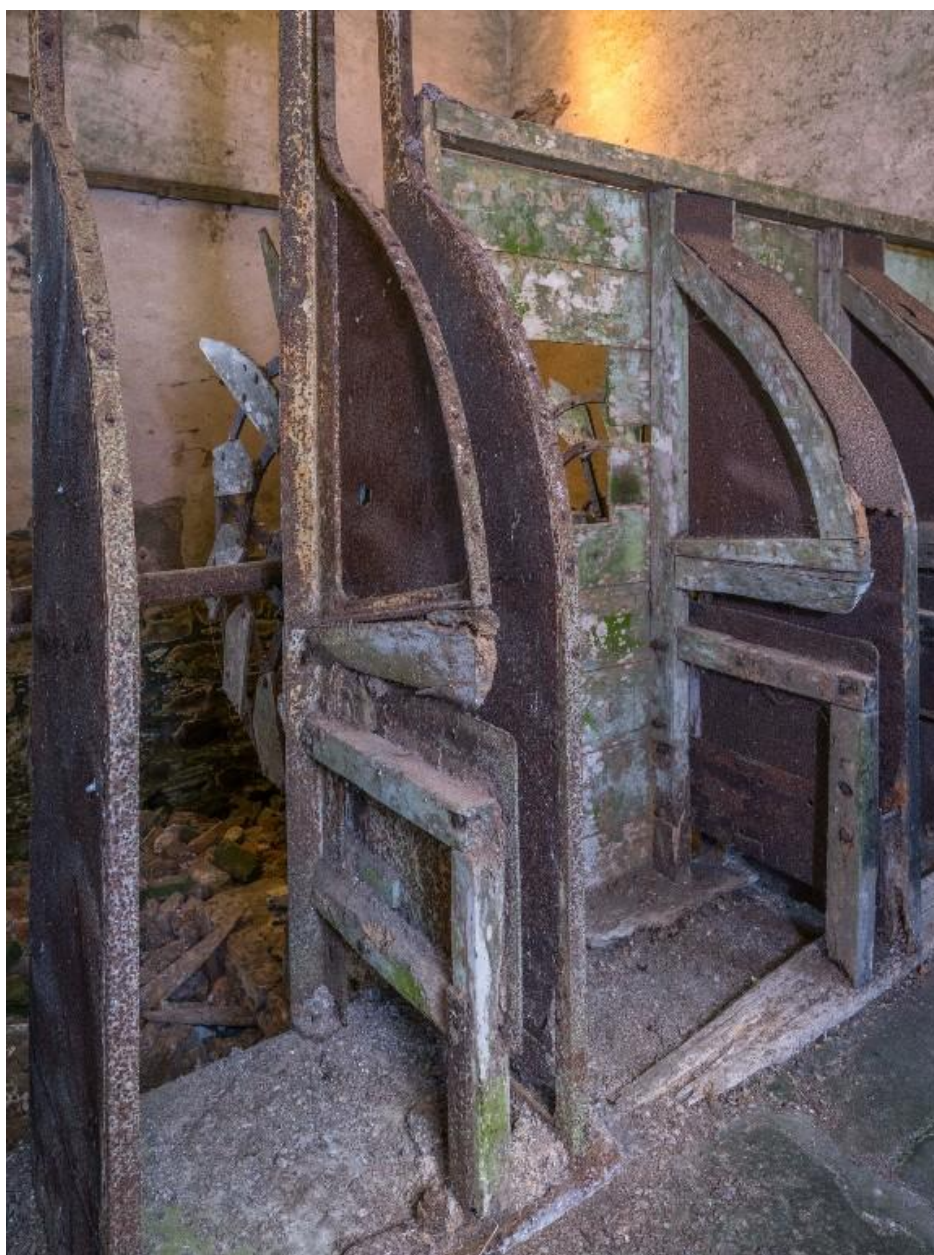
Bâtiment principal. Salle 3. Postes à espader
