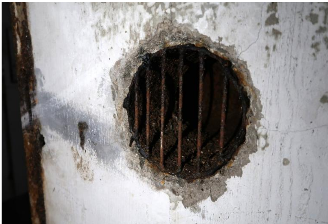
Vue du sas : tuyau avec sa grille de protection
