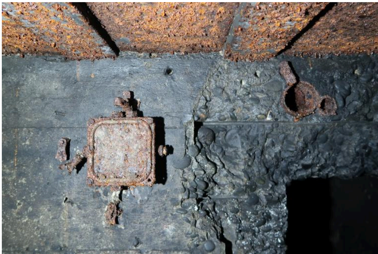
Vue intérieure : angle nord-est, détail du boîtier fixé au mur
