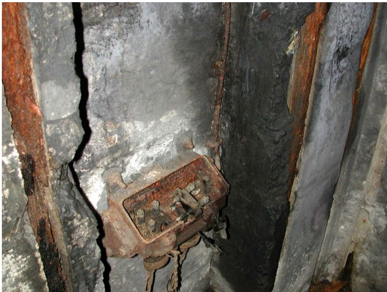
Vue du boîtier de connexion téléphonique dans sa niche
