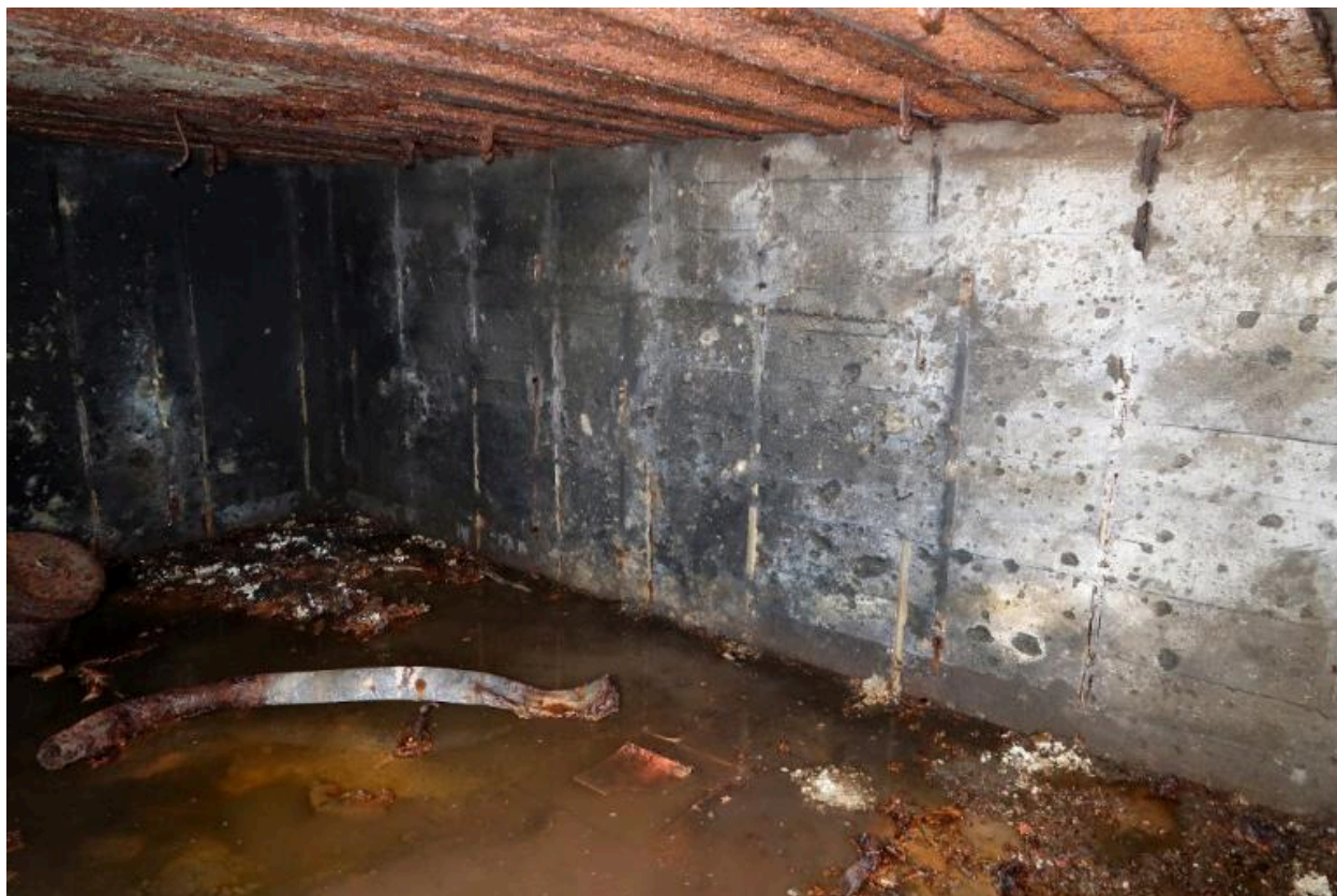
Vue de la salle de garde sud : les murs sont constellés d'éclats et noircis par la fumée. Au sol, baignant dans l'eau : tuyau de la ventilation et filtre à charbon du ventilateur
