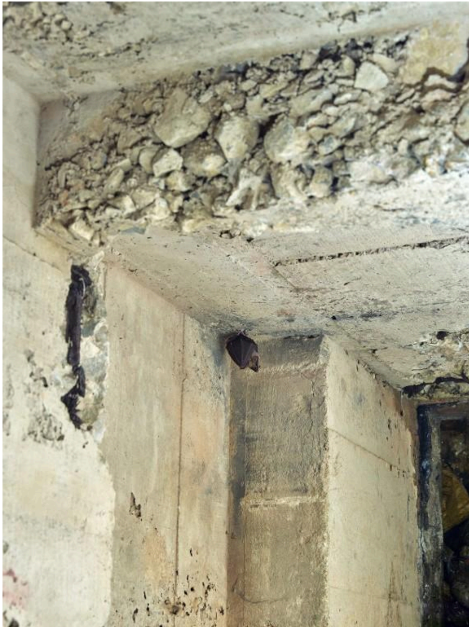
Vue de la salle des ventilateurs, sortie de secours (mur nord-est). Un Grand rhinophe (chauve-souris) - en hibernation durant l'hiver - y a élu domicile
