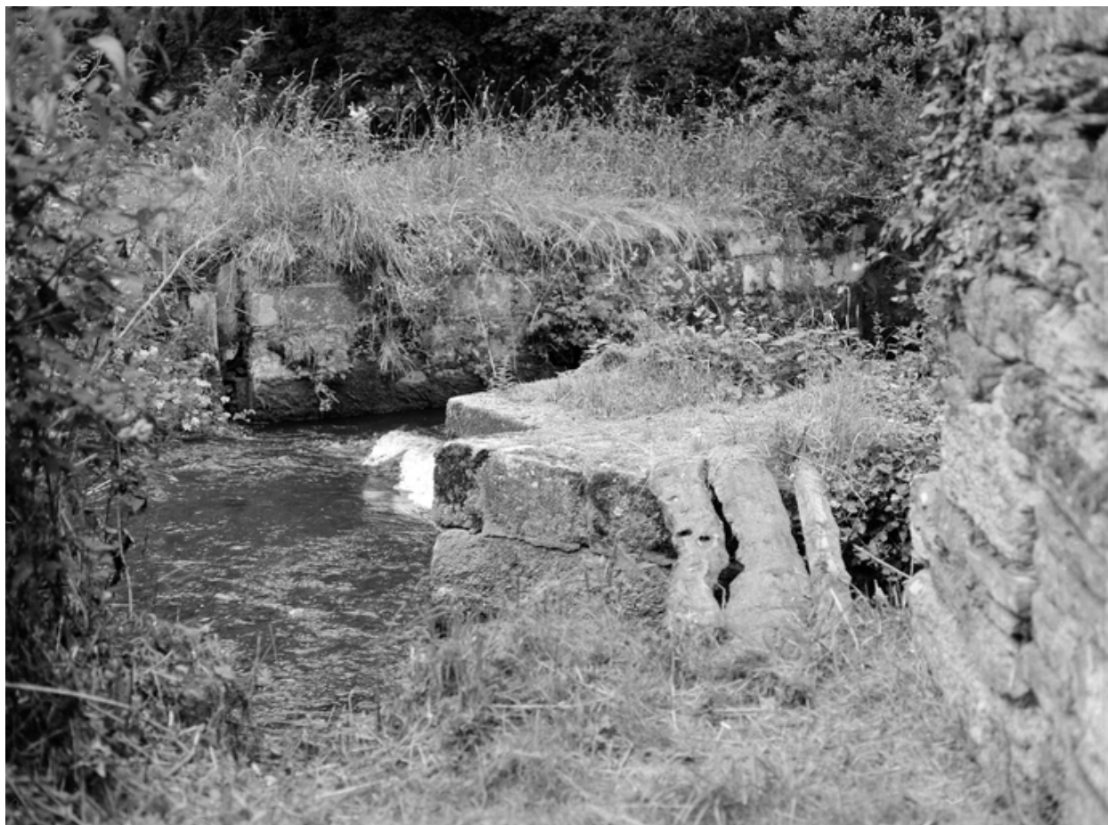
Détail des vannages.
