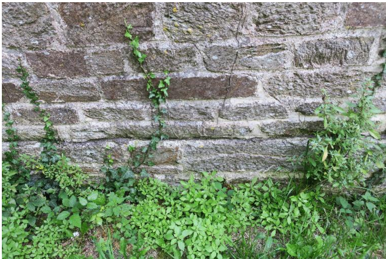
Le Palais, Port Larron, corps de garde crénelé, joint en bitume au bas des murs.
