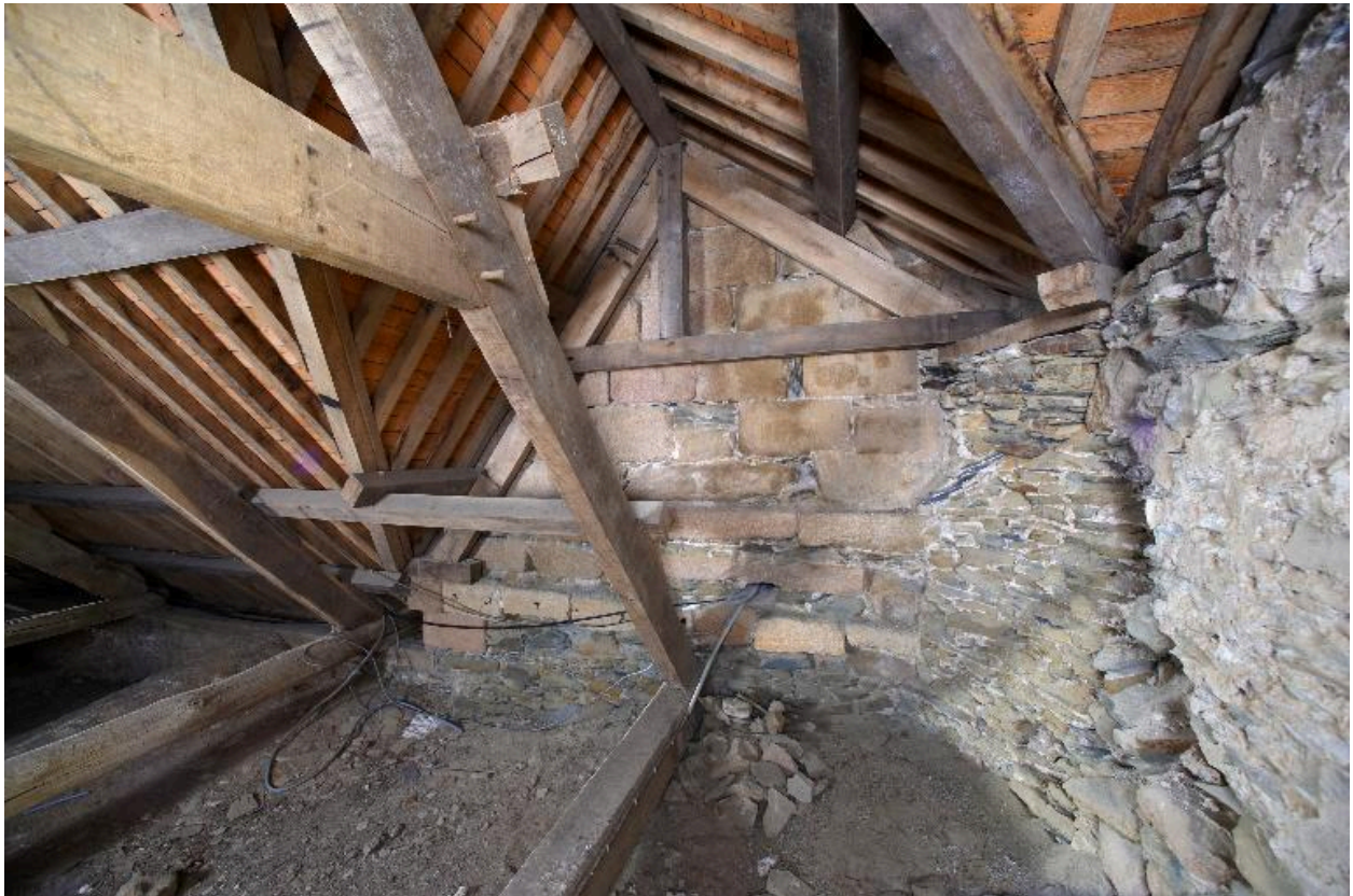
Comble de la nef, angle du pignon ouest et de la tour sud-ouest, vestiges de cheneau.
