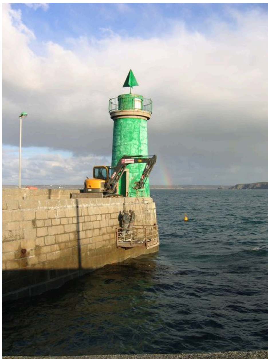
Feu de signalisation du Môle Vert
