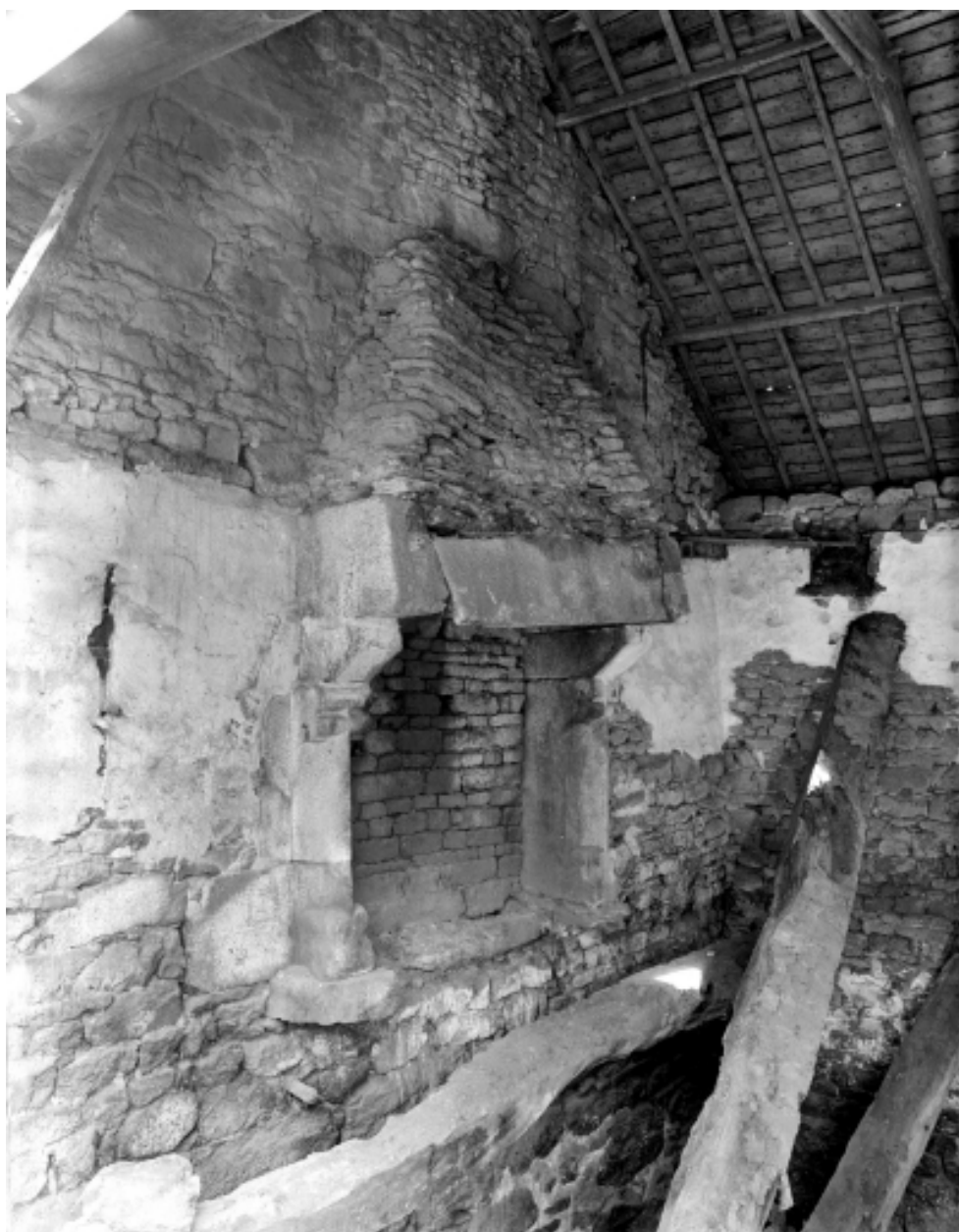
Cheminée du bâtiment ruiné
