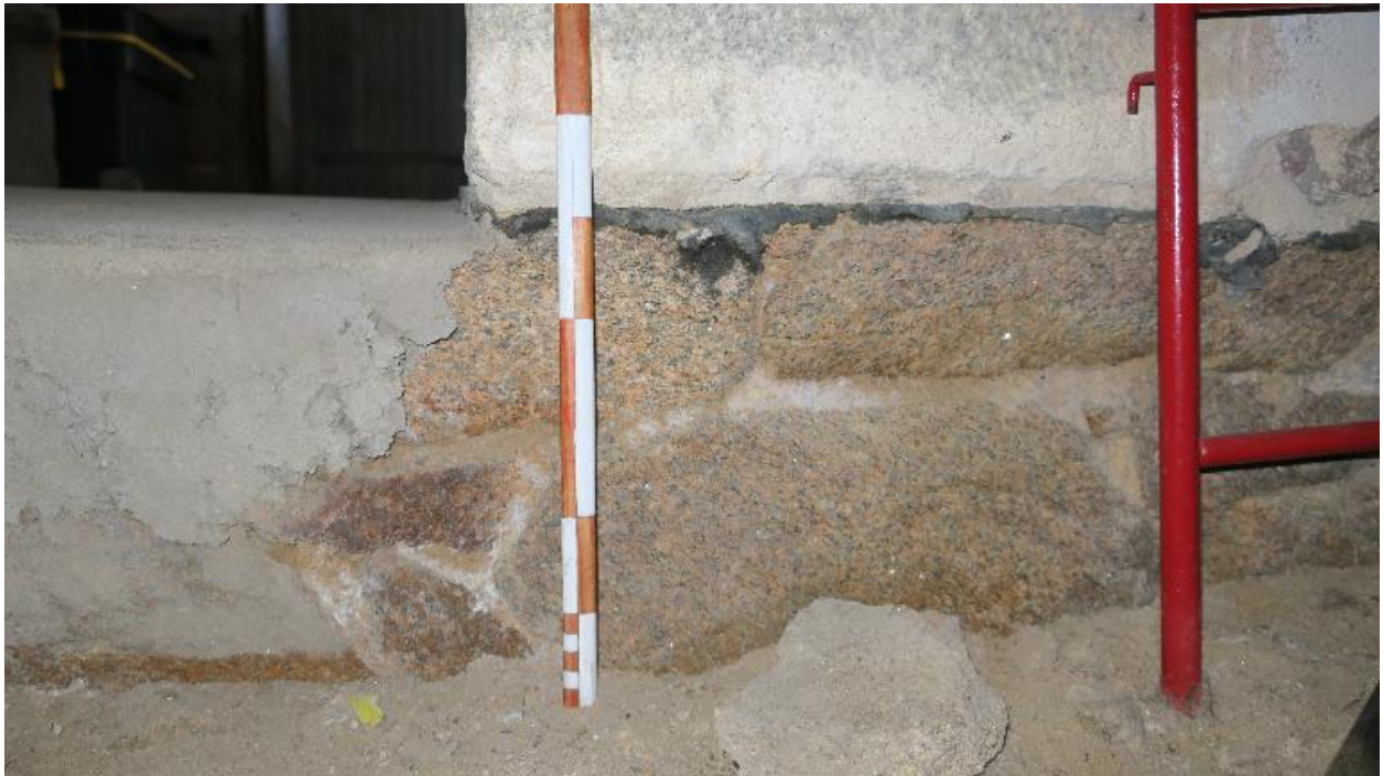
Île-d'Houat, batterie du Béniguet, corps de garde crénelé, couche d'enduit bitumineux visible dans le vide sanitaire d'un des magasins à poudre.
