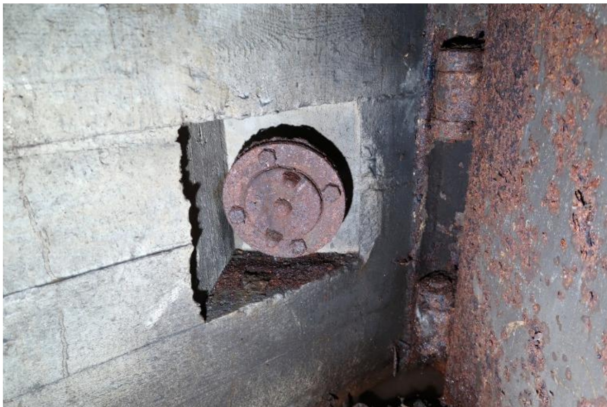
Vue de la petite salle située au nord-est : détail de la bouche de soufflage à vis réglable en métal située derrière la porte blindée
