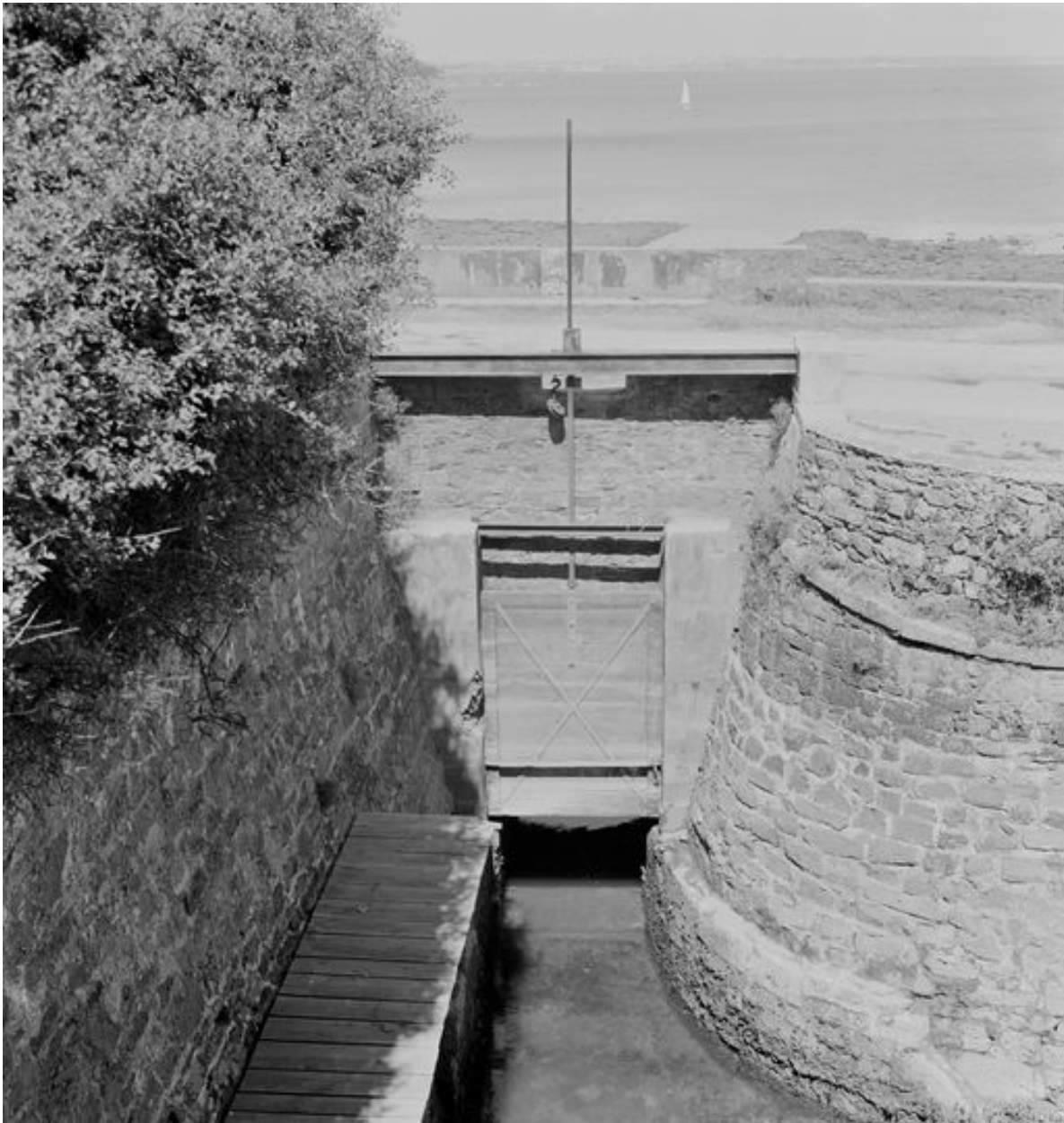
Vue des lignes de Quéléren en 1969 : écluse du bassin de retenue de l'orillon 8
