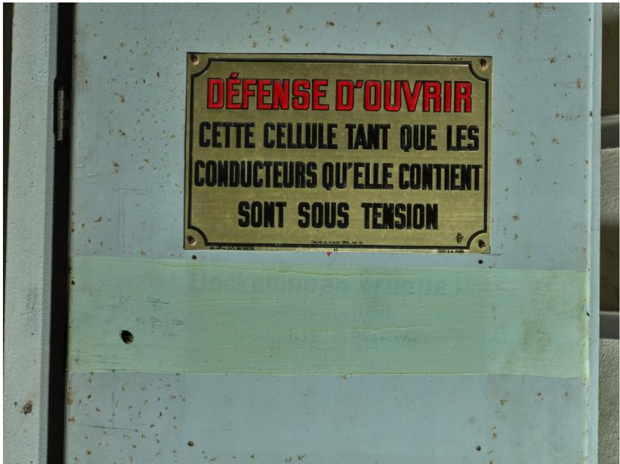
Vue de l'une des cellules hautes-tensions situées au deuxième étage : cellule n° 22, plaque signalétique et inscription en allemand (repeinte en gris) Dockpumpen Gruppe (pompes de quai)
