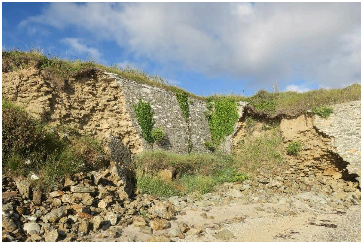
Locmaria, Grands Sables, dégâts sur l'escarpe.
