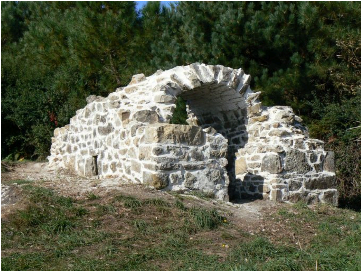
Vue du corps de garde restauré de la batterie haute du Kador
