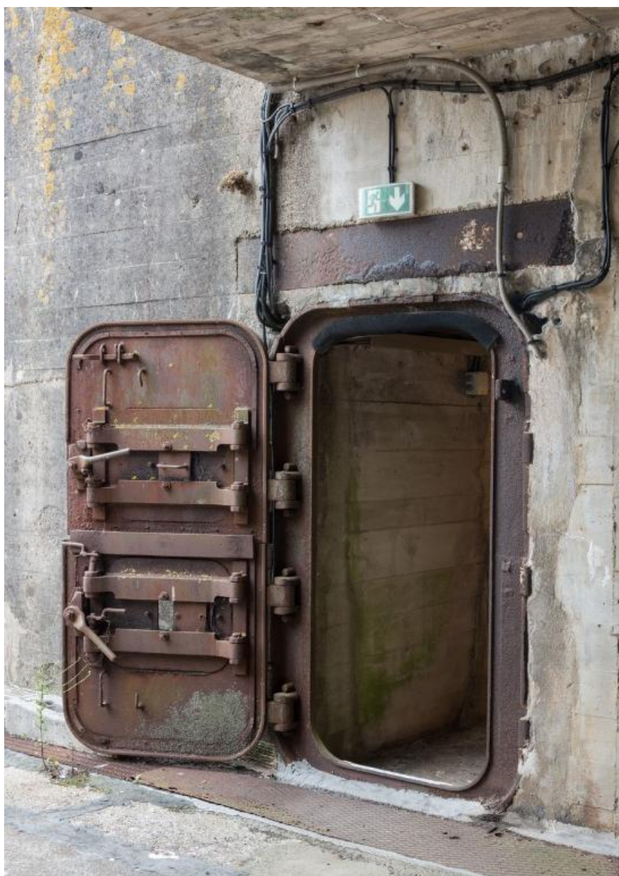
Vue de la porte blindée à deux vantaux donnant accès à la dalle de couverture
