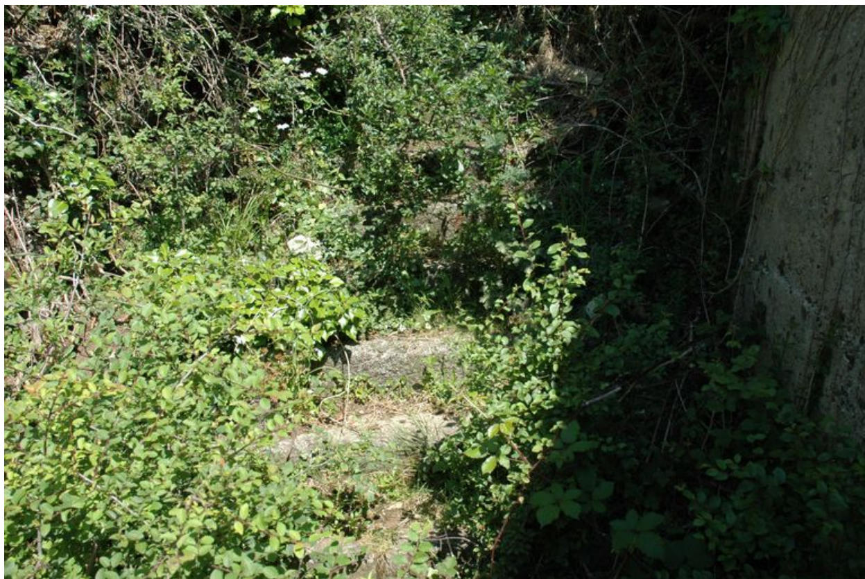
Vue de l'escalier en béton armé envahi par la végétation (état en 2005)
