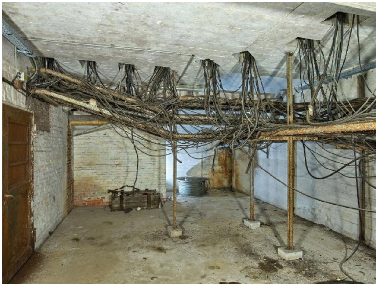
Vue du sous-sol de la centrale électrique : chemin de câble électrique alimentant la salle de commande située au rez-de-chaussée. Les murs de refend sont en brique
