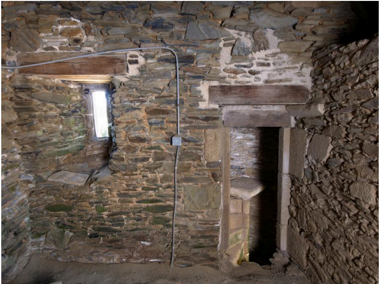
Construction d'angle nord-est. Pièce haute située au nord. Vue intérieure avec desserte de l'escalier en vis et jour
