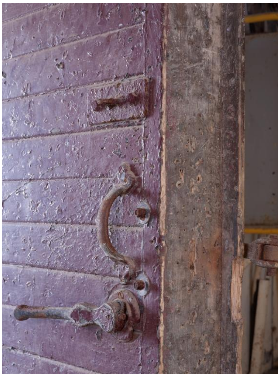
Système de fermeture des chambres froides (détail)
