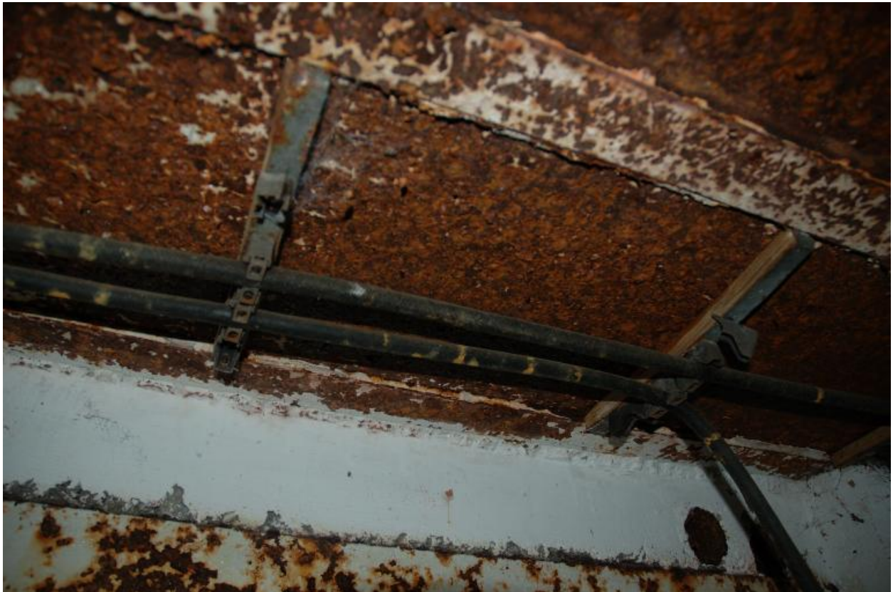
Vue des câbles électriques courant au plafond (2005)
