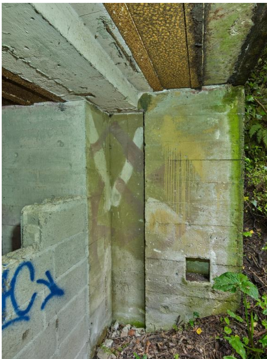
Vue de l'entrée (partiellement murée par des parpaings) : sur le mur Est, traces de peinture camouflage
