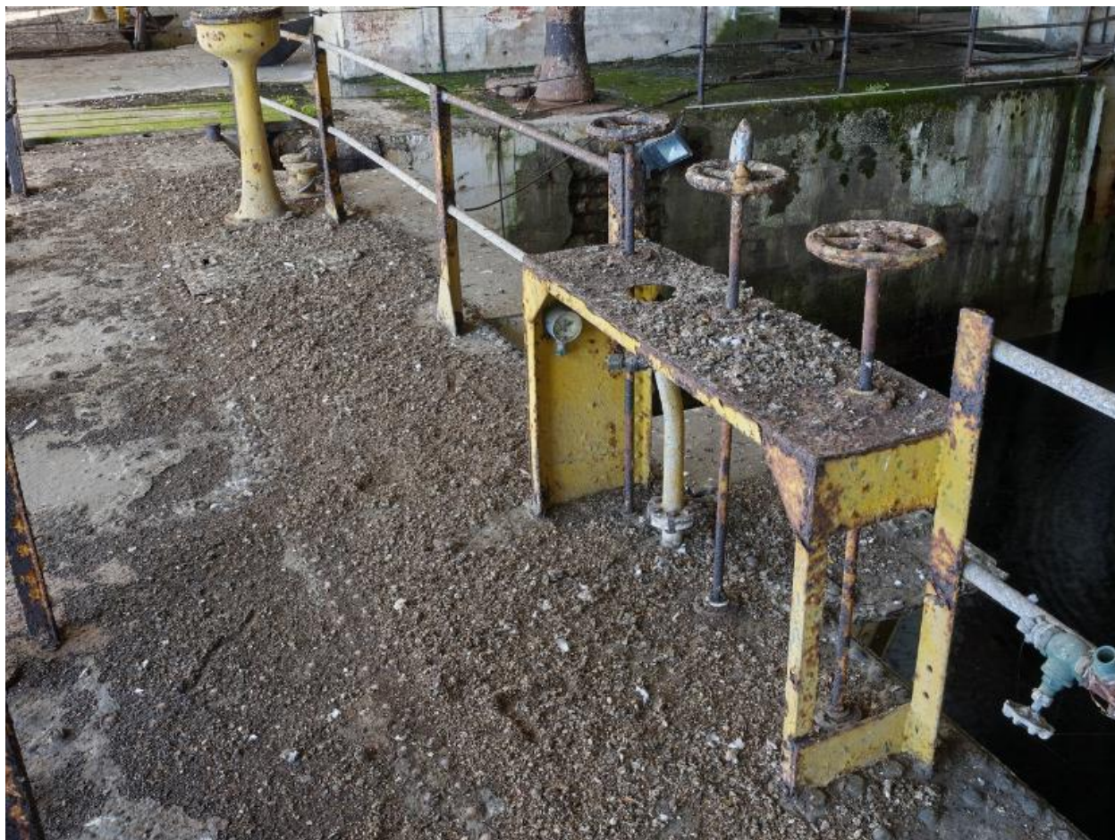
Vue des commandes des vannes de ballast du bateau-porte fermant le bassin (vers l'intérieur)
