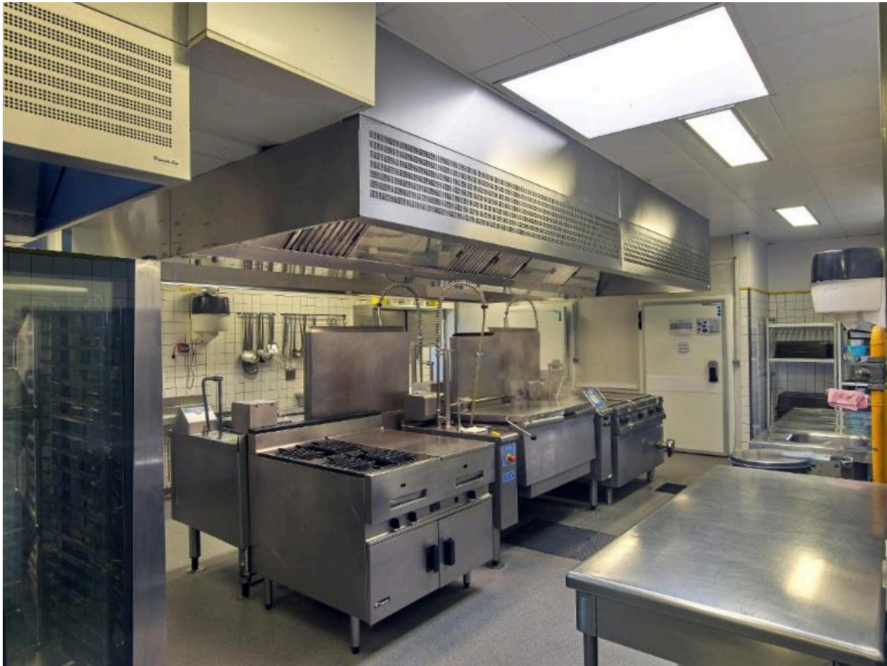
Restauration scolaire : les cuisines.
