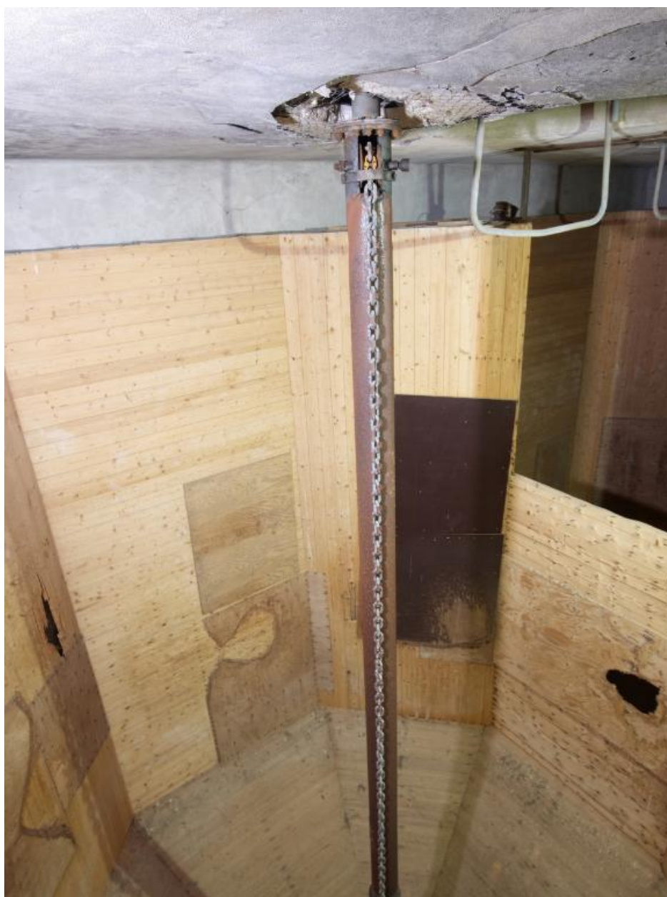
Machine pour fabrication des paillettes de glace (côté nord)
