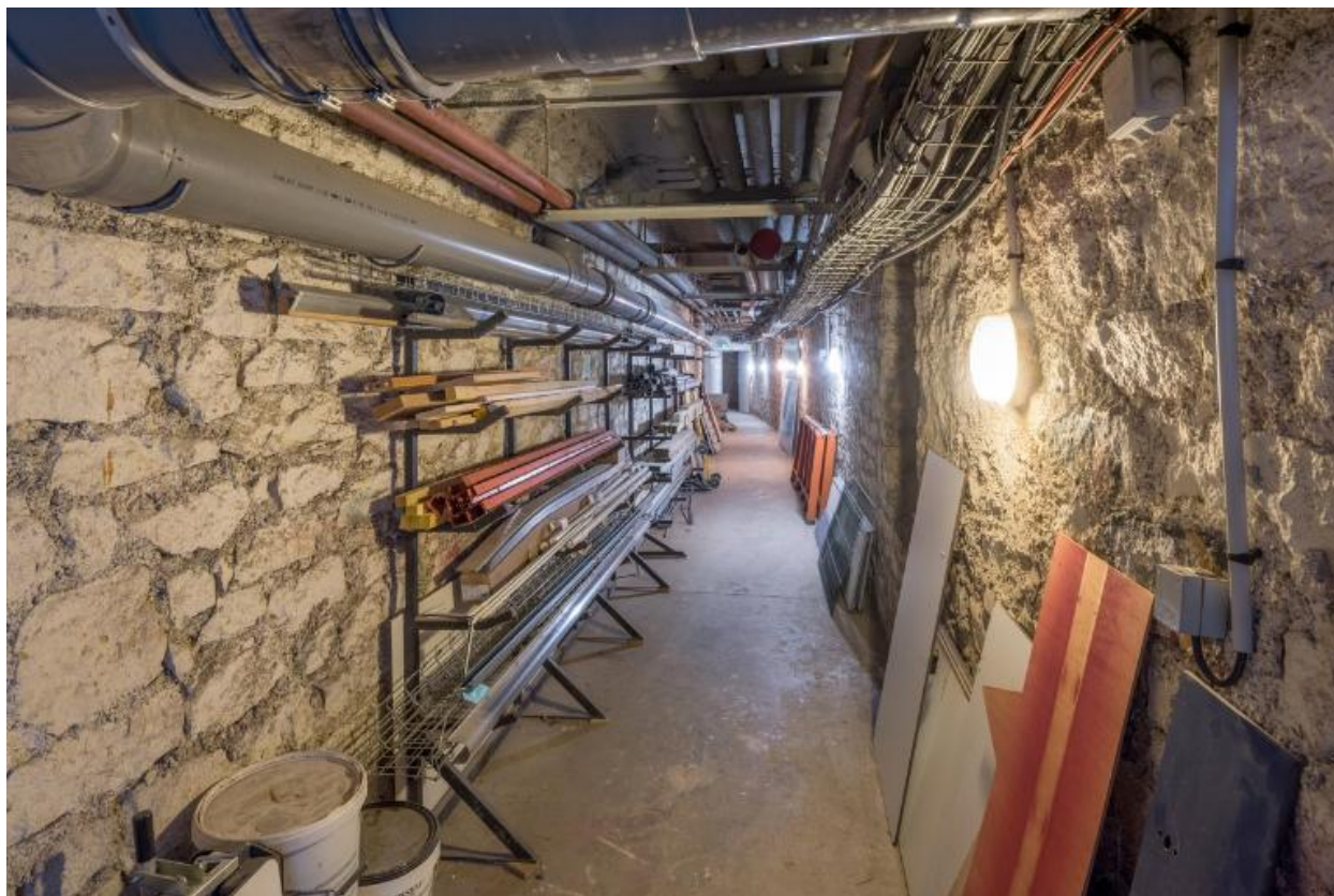
Galerie technique en sous-sol.
