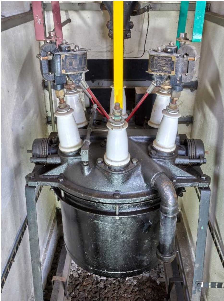
Vue de l'une des cellules hautes-tensions situées au deuxième étage : cellule n° 22, disjoncteur des Forges et ateliers des productions électriques de Jeumont. La cuve est remplie d'huile pour dissiper la chaleur : elle s'ouvre avec deux câbles
