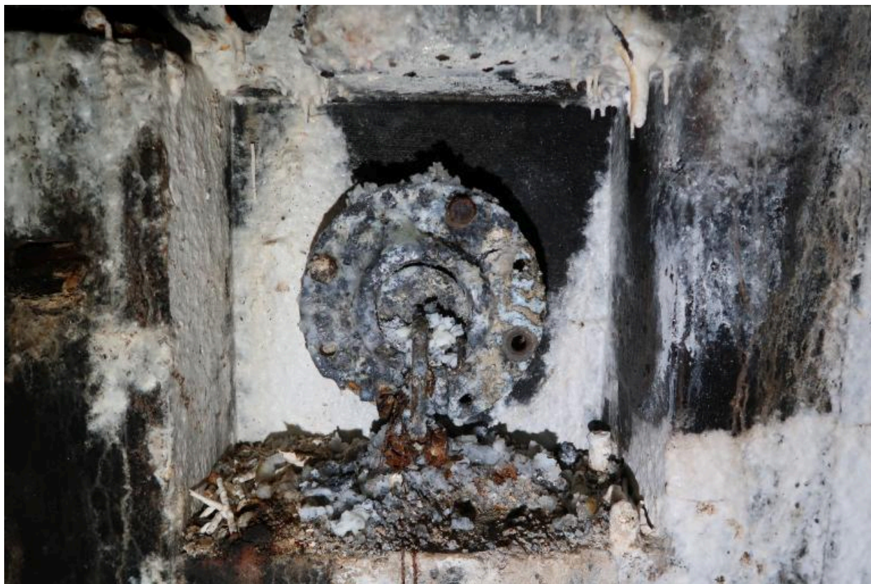
Vue du clapet/bouche de surpression du sas
