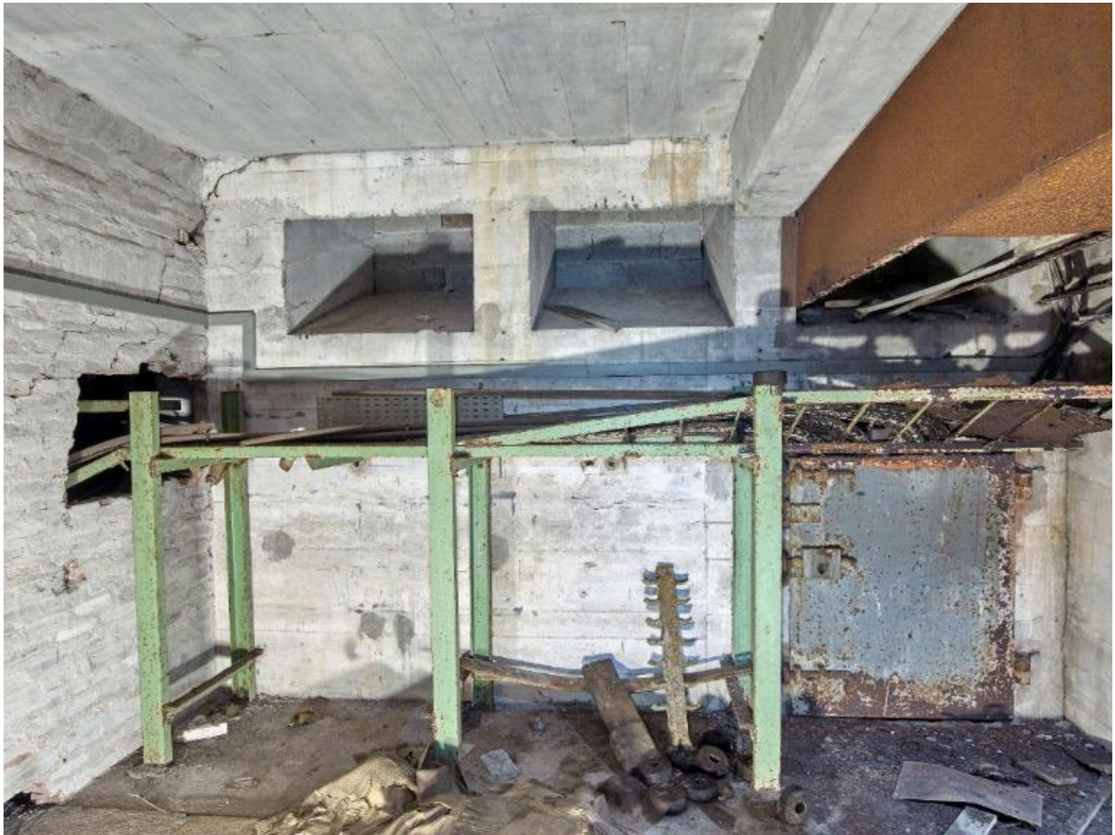
Vue du sous-sol de la centrale électrique : extrémité est, chemin de câble électrique. La porte blindée donne sur la galerie technique souterraine qui dessert les bunkers KI, KII et KIII
