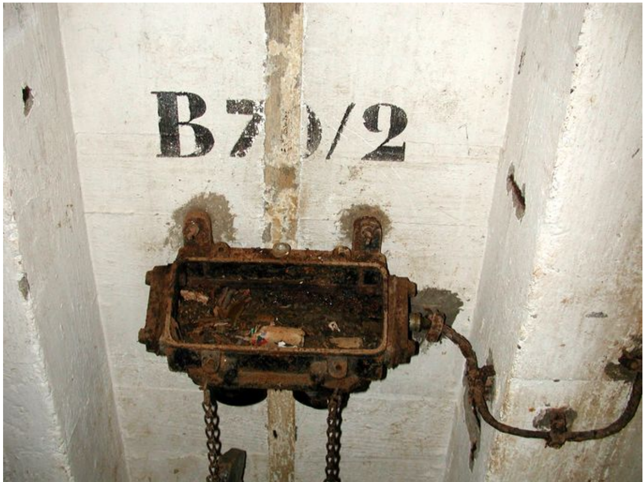
Vue du boîtier de connexion téléphonique - en position ouvert - surmonté du marquage B 70/2
