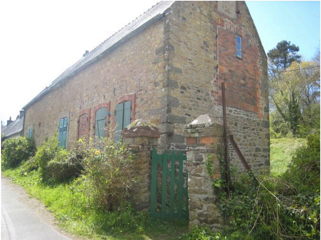
Vue de la villa-pension La Pagode avec ouverture murée sur le pignon nord qui servait aux artistes
