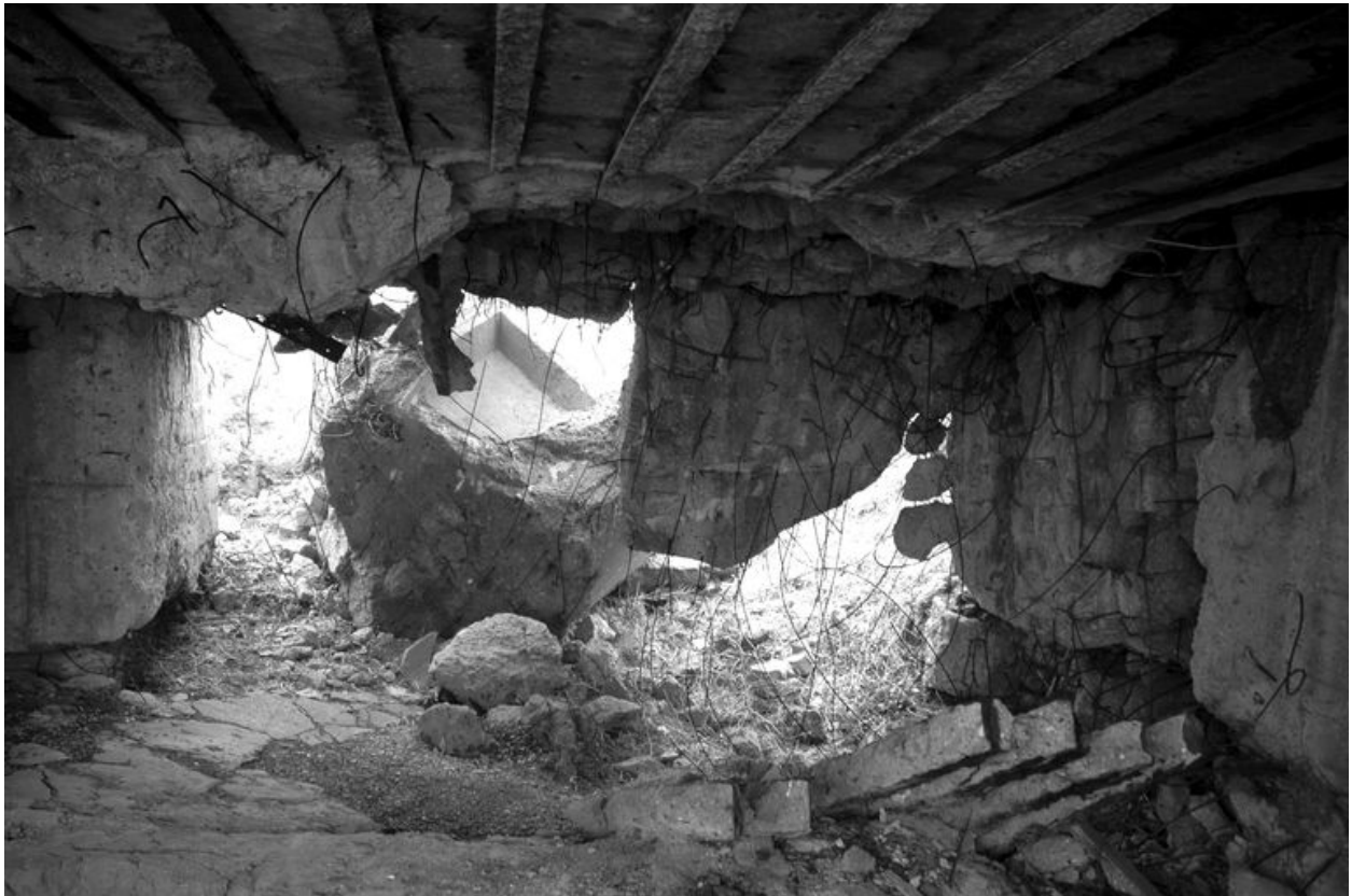
Vue intérieure de l'une des quatre casemates de la batterie de Longues-sur-Mer (casemate est en partie ruinée)
