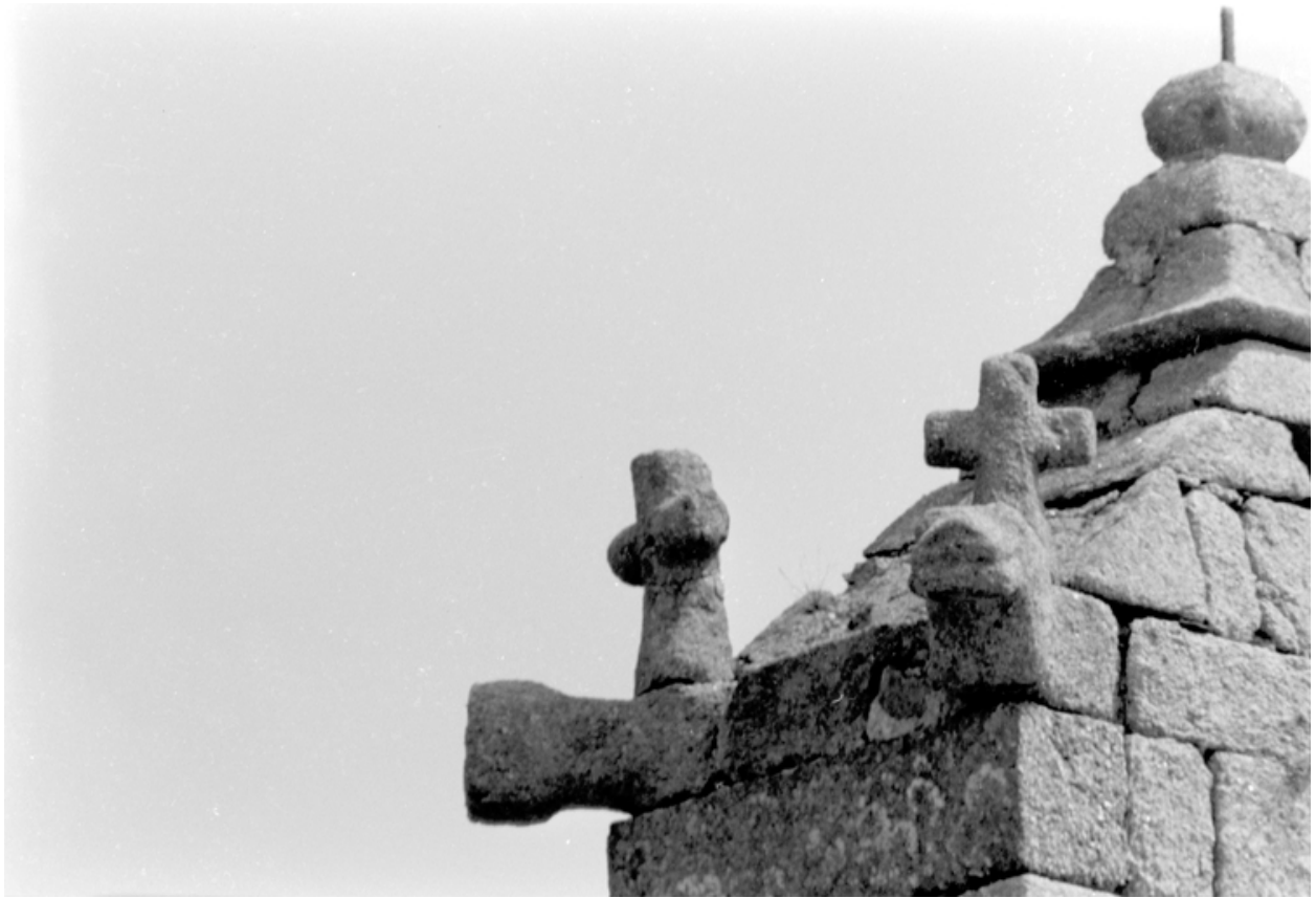
Face nord : clocheton ouest, détail de la gargouille nord-est et nord-ouest
