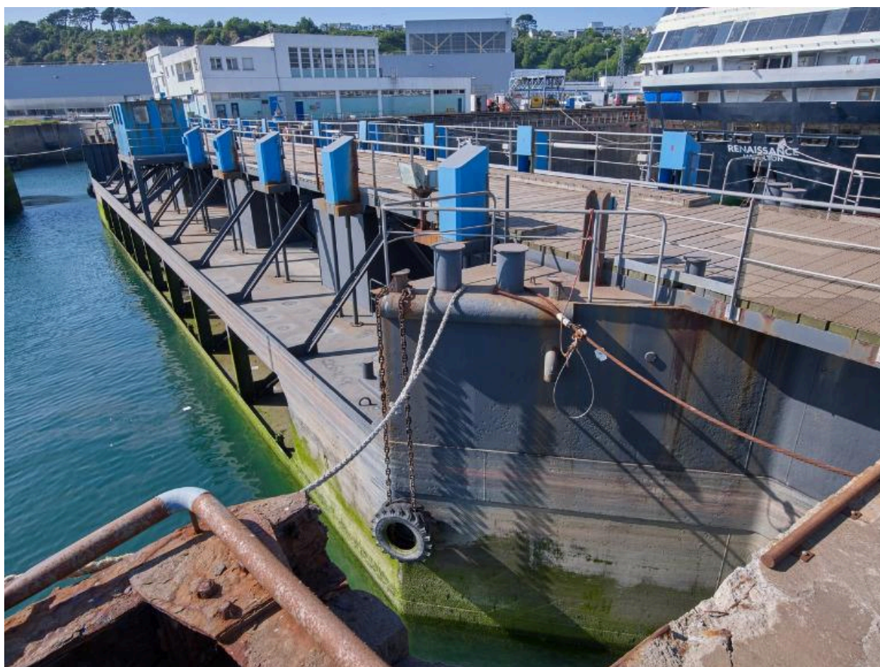
Bateau-porte de la forme de radoub n°2
